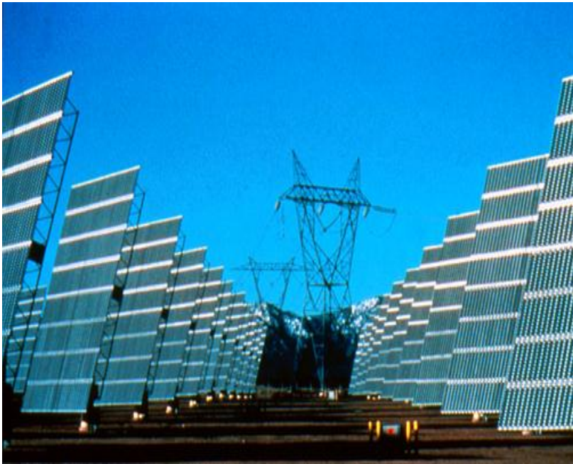
1 MWp, Primera central – California
