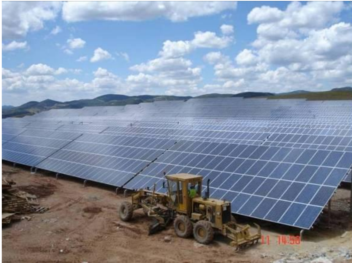
4 MW em Jaén, Espanha
