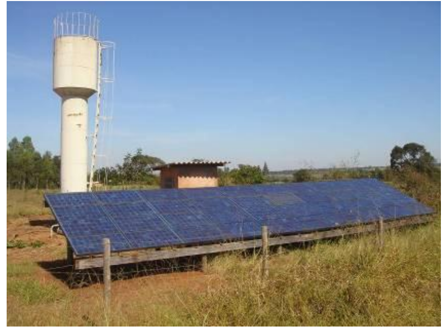
Bombeamento, Projeto LSF-IEE, ITESP, Presidente Bernardes, SP Bomba e acondicionamento de potência de fabricação nacional
